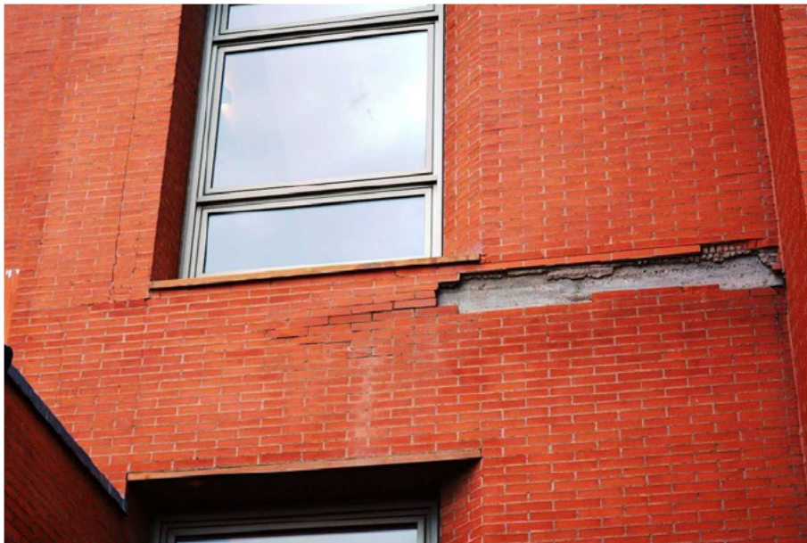
Desprendimiento de piezas cerámicas en el canto del forjado
