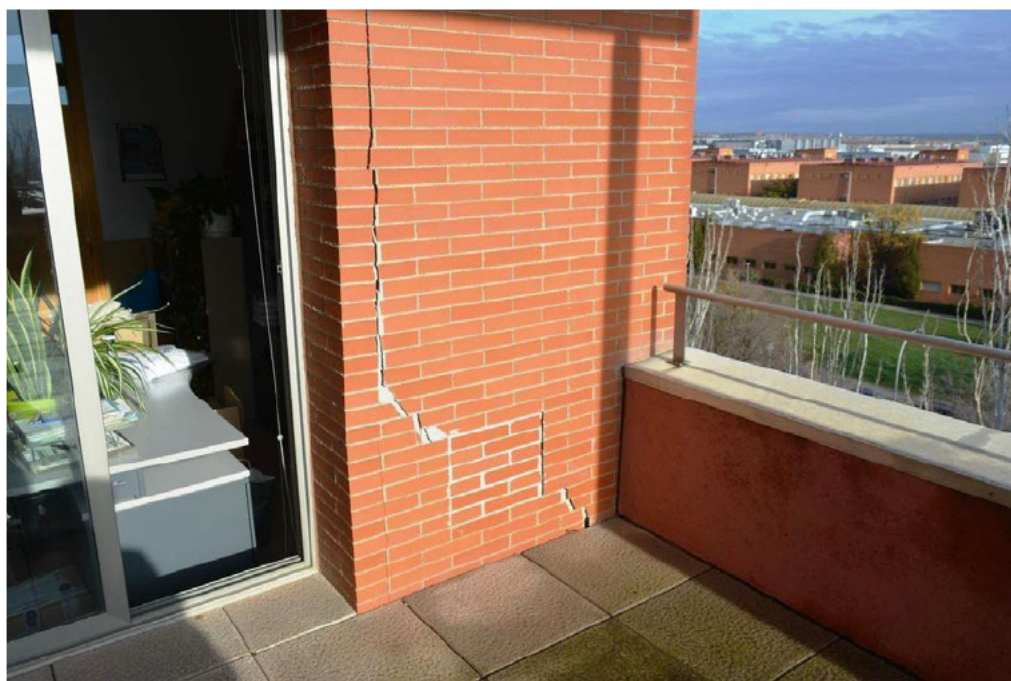
Daños junto a ventanas
